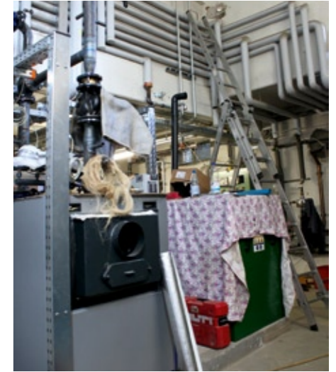
Das Herzstück der neuen Energieversorgungsanlage der Sport- und Festhalle: Heizkessel und Blockheizkraftwerk
