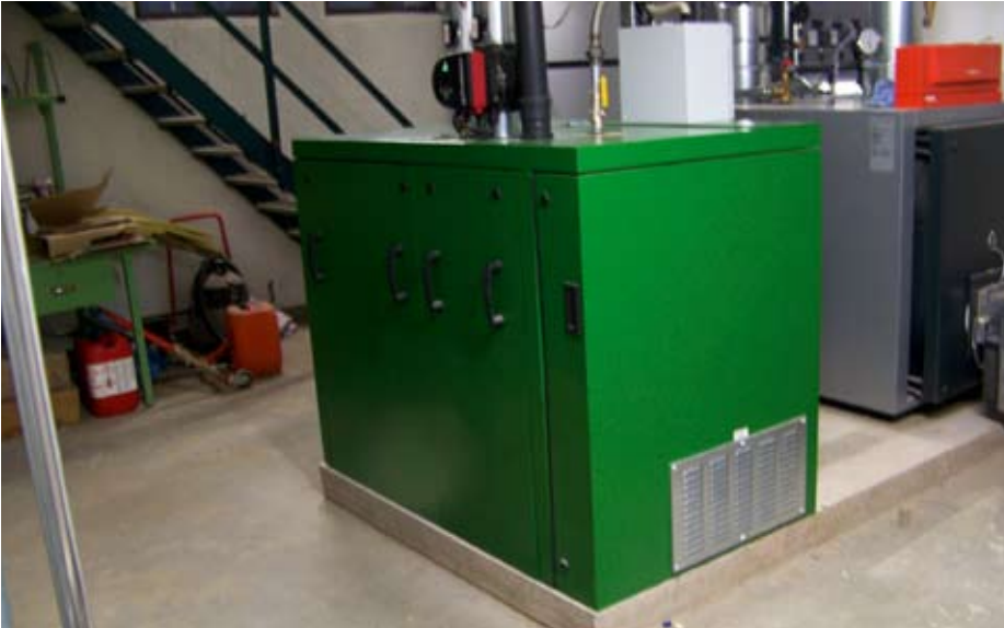
Das neue „Herz“ der Heizungsanlage- und Energiezentrale in der Sport- und Festhalle „Am Guckenberg“: Das energieeffiziente Blockheizkraftwerk im Hallenkeller als Heiz- und Stromerzeuger ist seit wenigen Tagen in Betrieb.
